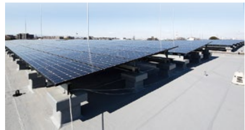
屋上に設置されたソーラーパネル
