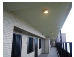
開放廊下LED照明
