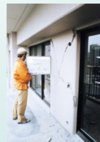
被害状況の調査の様子
